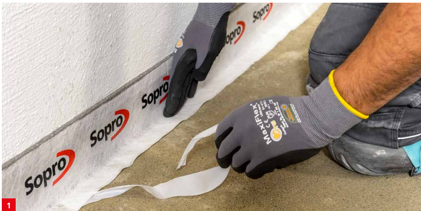
1 Stellen des Sopro EstrichRanddämmstreifens. Anzeichnen des Meterrisses und der Orientierungspunkte. Zu berücksichtigen sind die erforderlichen Einbauhöhen: Sopro SMART® Leichtausgleich (> 20 mm im Verbund), Sopro VarioFließspachtel (> 10 mm), Kleberschicht und Stärke der Keramik.
