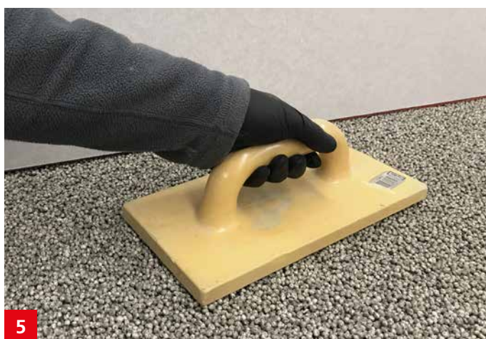
Das eingebrachte Material nochmals an der Oberfläche verdichten und partielle Überstände entfernen.
