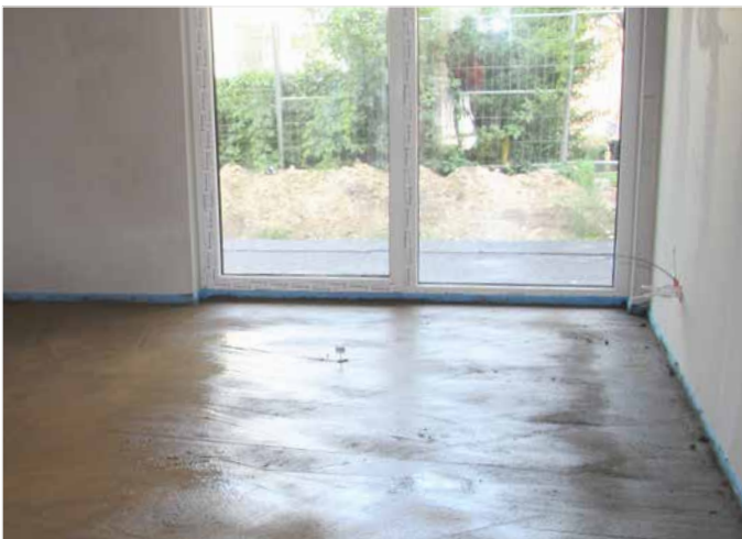
Überwässerter Estrich (zu viel Anmachwasser)
