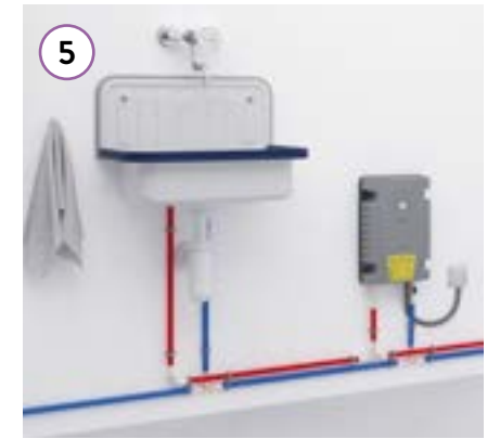
Aufputz-Installation im Hauswirtschaftsraum
