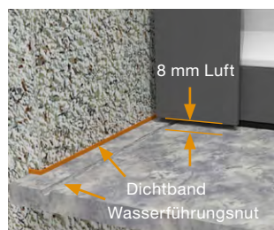
Nicht eingeputzte Führungsschiene mit Steinfensterbank
