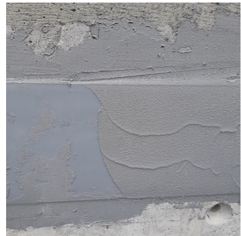
Verklebung von PCI Pecitape 3000 - Abdichtungsband mit PCI Barrafix EP Fein während Überbeschichtung und vor Glätten.
