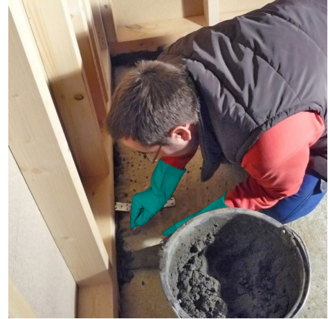
Unterstopfen von Holzrahmen mit PCI Repaflow USM, um einen kraftschlüssigen Verbund zur Bodenplatte herzustellen.
