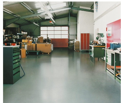
PCI Apoten-Beschichtung in einem Gewerbebetrieb mit hoher mechanischer und chemischer Belastung.
