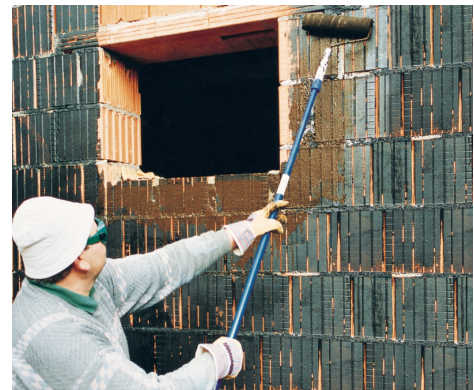
PCI Pecimor F, 1 : 5 mit Wasser verdünnt, als Grundierung für eine Bauwerksabdichtung mit kunststoffmodifizierter Bitumendickbeschichtung nach DIN 18 533.
