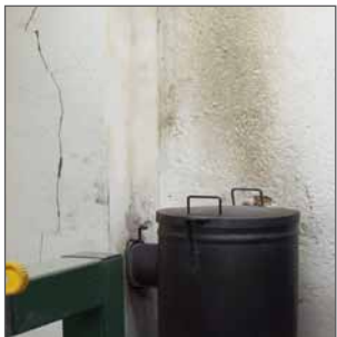
Rissegefahr durch Spannungen infolge hoher Temperaturdifferenzen.
