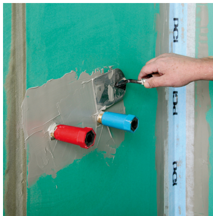
Auch zum Abdichten der Wasserzuleitungen mit der Dichtmanschette PCI Pecitape 10 x 10 wird zunächst ausreichend viel Abdichtungsmaterial vorgelegt...
