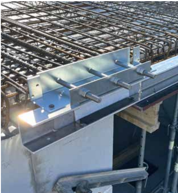
Abb. 3: IQ K-B Teilset Decke, Montageset (Part MS) und Bewehrung verlegen. Anschließende Betonage
