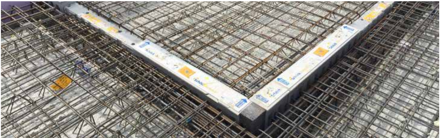
Der Druckfugenbereich wird gemeinsam mit der Decke mit Ortbeton vergossen, die Balkonplatte wird überhöht eingebaut
