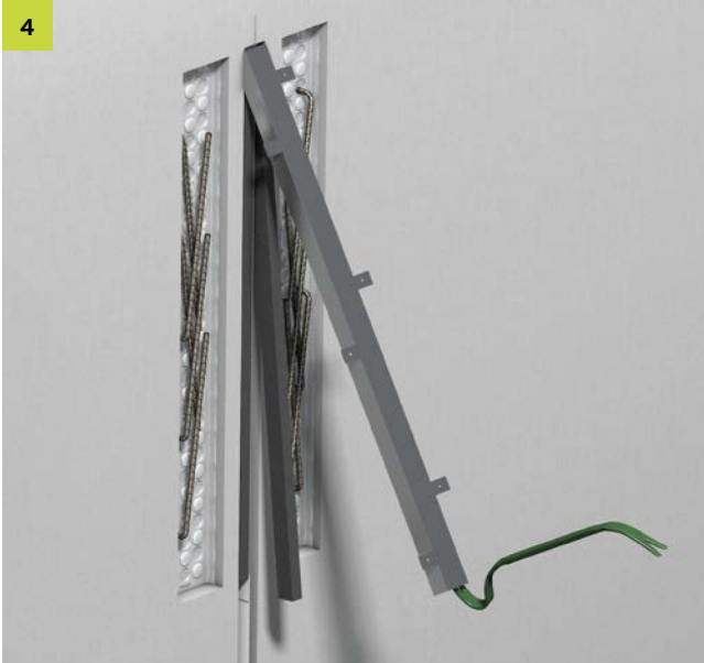
Nach dem ersten Betonierabschnitt die Verwehrkästen der FERBOX® Rückbiegeanschlüsse, die Verwahboxen der PENTAFLEX® Module sowie die Füllstreifen entfernen.
