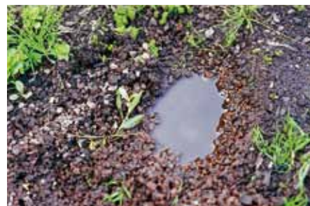
Die Dränfunktion dieser „Dachbegrünung“ ist offensichtlich unzureichend...
