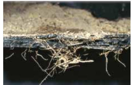
Eine von Wurzeln durchdrungene Bitumenabdichtung ohne Wurzelschutzausrüstung.
