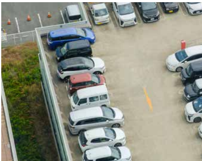
Abb. 44: Parkdach mit Ortbetonfahrbelag.
